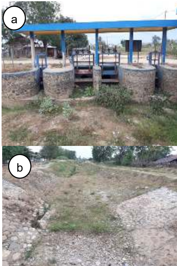
Gambar 3. (a) Pengatur air pada saluran irigasi di Desa Jono Oge yang mengalami kerusakan; (b) Tanggul pada pada saluran irigasi di Desa Jono Oge
